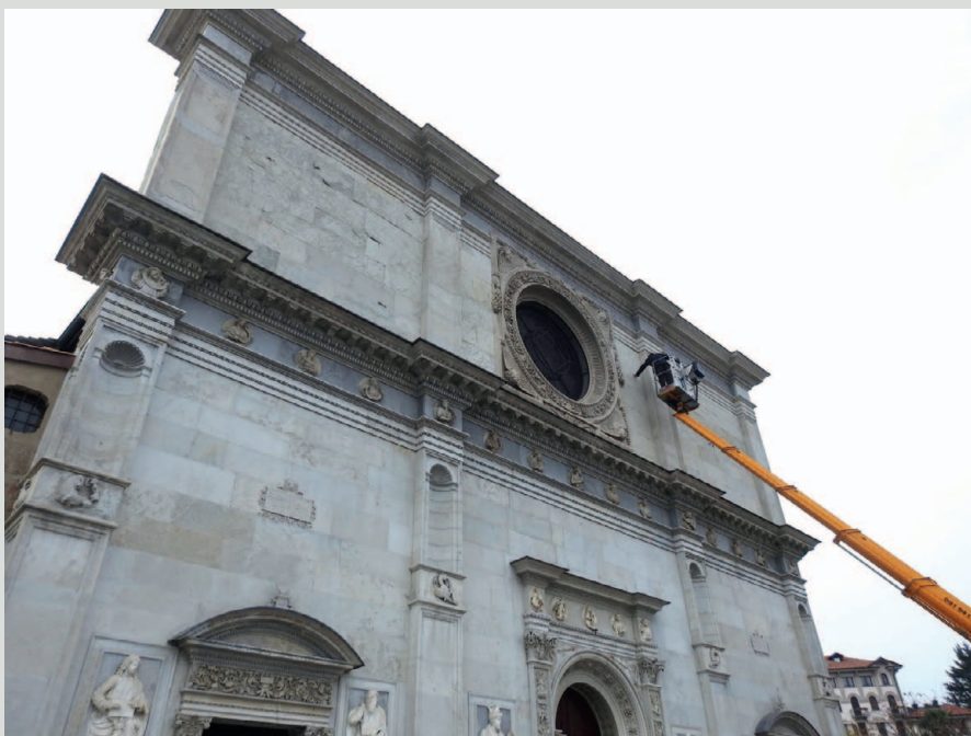
Cathédrale de San Lorenzo, Lugano. Inspection de la surface en pierre à l'aide d'une nacelle. © SUPSI
