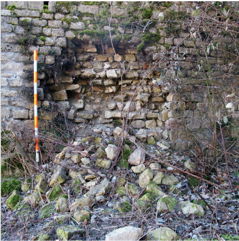
Fig. 1 : Tour 2 de la porte de l'Est de l'enceinte romaine d'Avenches : effondrement de parement ayant laissé une lacune de près de 30 cm de profondeur dans un mur. © Site et Musée romains d'Avenches
