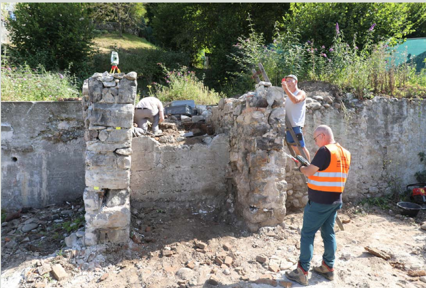
Abb. 4: Nach dem Abbruch des Gebäudes im Jahr 2021 konnten die beiden Töpferöfen genauer untersucht und dokumentiert werden. Zu Testzwecken entschied man sich, den Ofen photogrammetrisch zu dokumentieren. © Marco Amstutz, Archäologischer Dienst Bern
